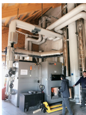
バイオマスエネルギー供給施設
