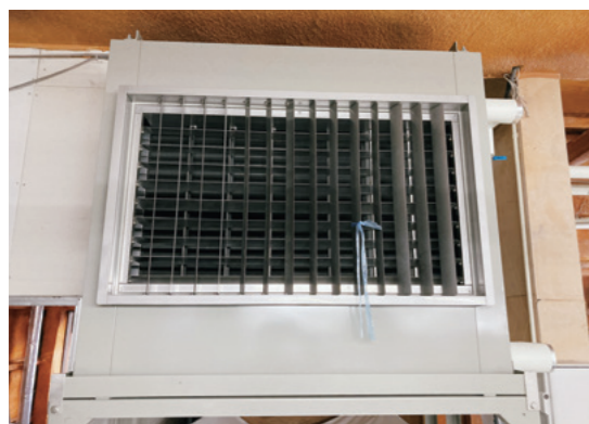
設置した井戸水ユニットクーラー
