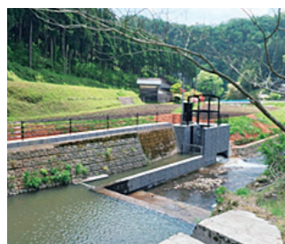
春蘭の里の小水力発電施設
