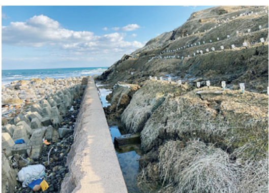
幾筋にもわたって深い亀裂が入った白米千枚田。一部、地滑りで崩れた田んぼもありました
