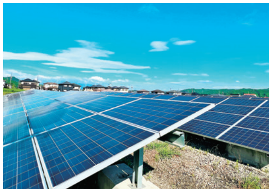
太陽光パネル
