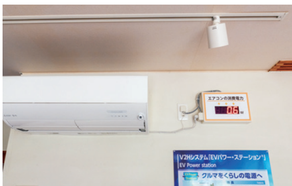
消費電力の多いエアコンや冷蔵庫、照明などの電力をリアルタイムで見える化する装置
